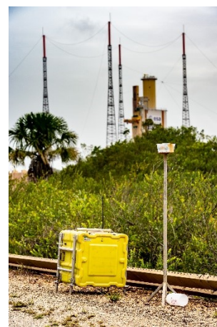
Figure 6 : SPM mobile installé en champ proche
